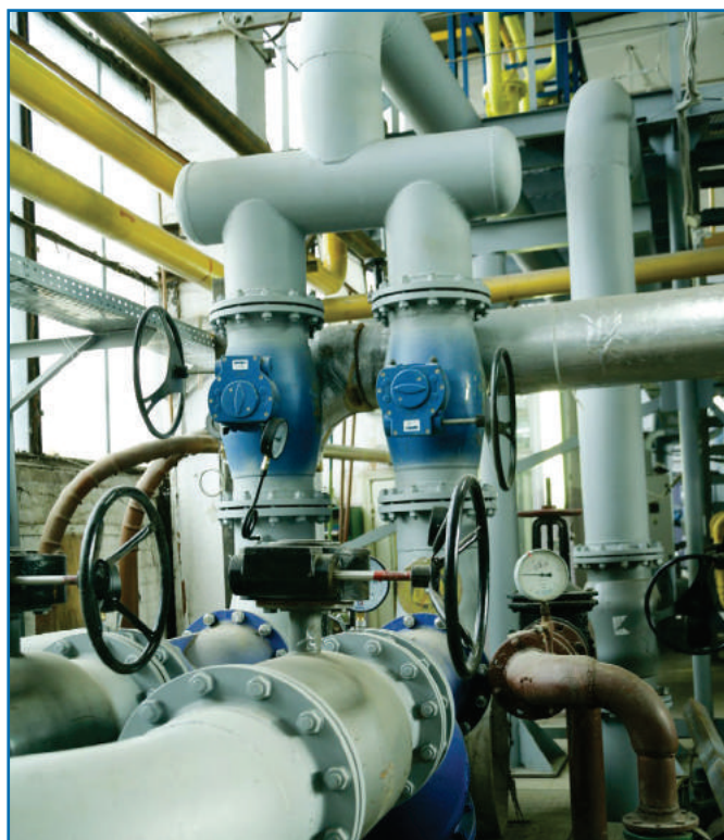
Рисунок 1. Оборудование одной из котельных ОАО «Теплоэнерго», Ипподром, г. Нижний Новгород.
